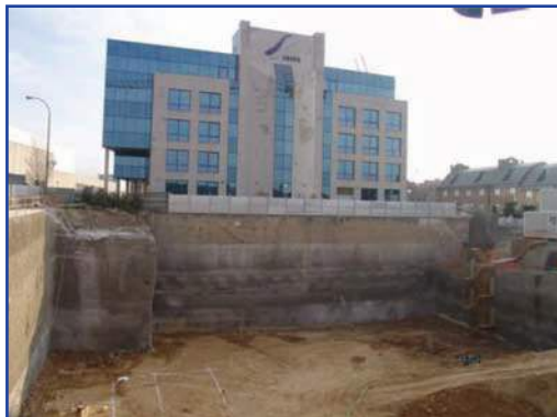
Ejemplo de estabilización con sistema INGEONAIL de 12m de profundidad mediante combinación de anclajes activo y pasivos conteniendo estructura medianera
